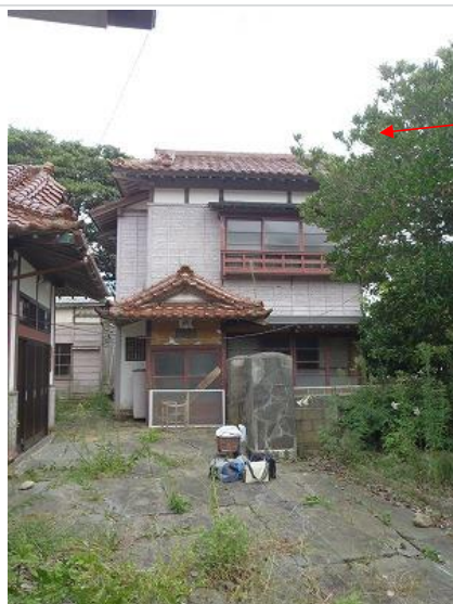
離れ玄関の 土壁が落下
